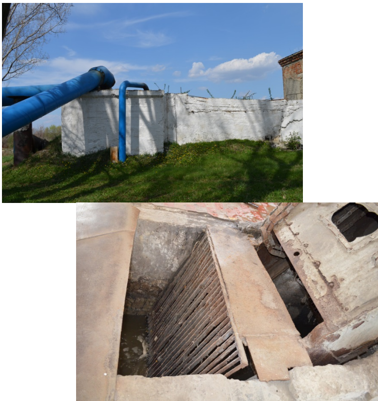
Figura 4-11. Stația de epurare a apelor uzate: Disipatorul de energie. Grătarele mecanice
