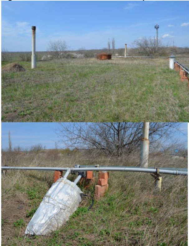
Figura 4-3. Rezervoarele subterane de apă cu volumul 6.000 m3
