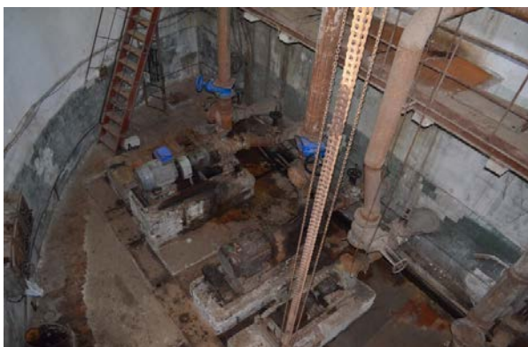
Figura 4-10. Stația de pompare a apelor uzate SPAU-1
