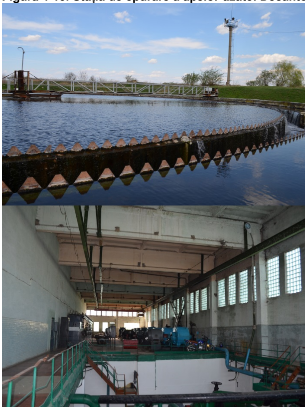
Figura 4-13. Stația de epurare a apelor uzate: Decantoare secundare. Bazinul de contact
