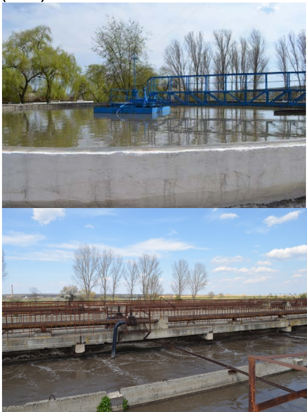
Figura 4-12. Stația de epurare a apelor uzate: Decantor primar. Bazin de aerare cu nămol activ (BANA)
