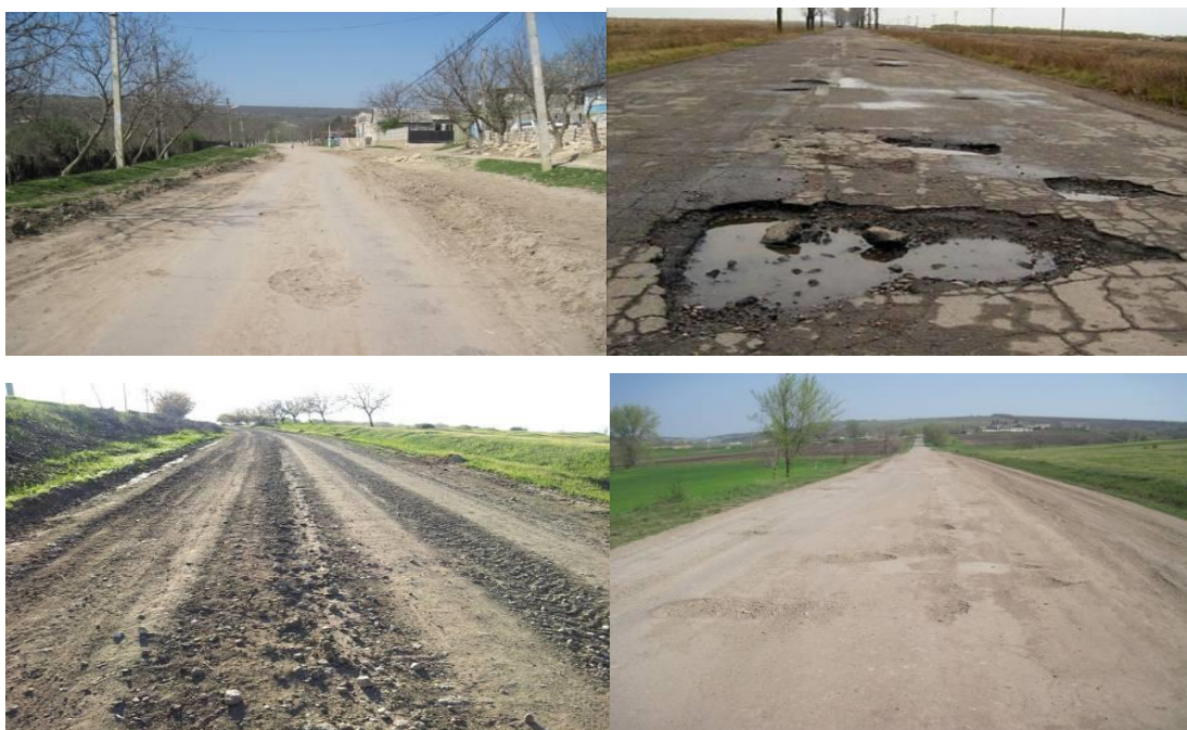
Figura 2-10: Degradări ale drumurilor locale
