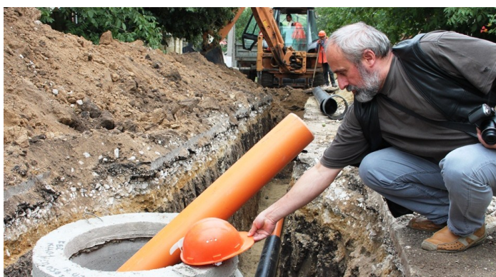
Șantier în orașul Orhei. Profesorul Nicolae POJOGA vorbește despre specificul fotografiilor de infrastructură.
